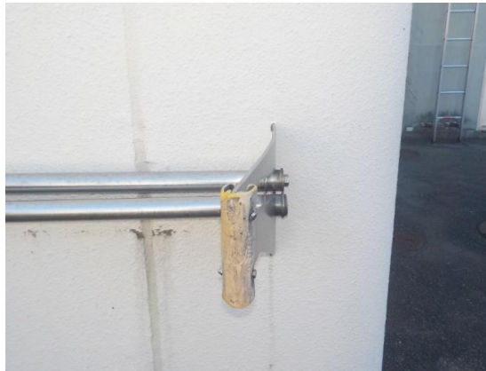
トラックが接触し、曲がった金物
