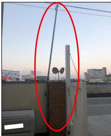
破損箇所(ポール)
