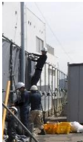
対策状況イメージ (事故発生箇所シート取り外し)
