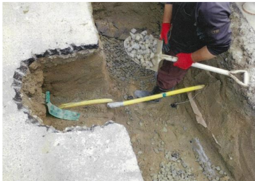
ガス管破断状況
