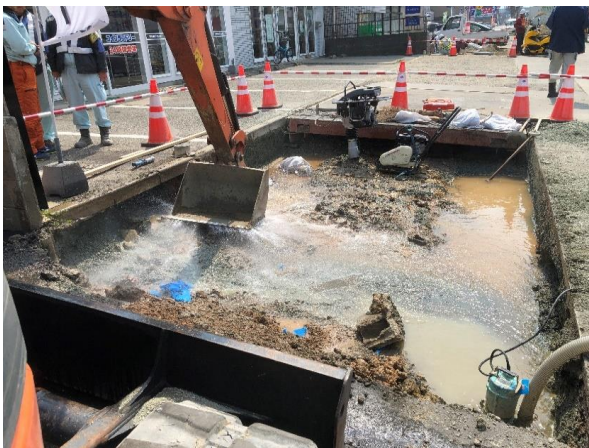
覆工板設置のための床掘作業中、バックホウで給水管を破損させた。
