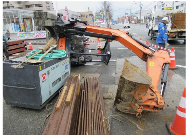
軽量鋼矢板(L=2.5m 740kg)を吊り降し中、バランスを崩して転倒した。
