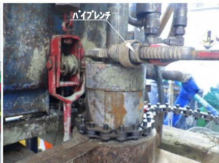
パイプレンチによるロッド回転状況(下部設備との隙間なし)
