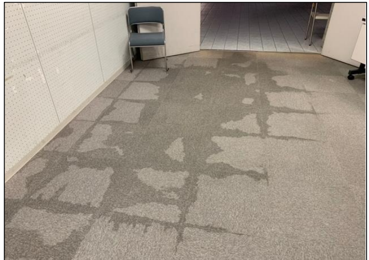
1階の漏水状況
