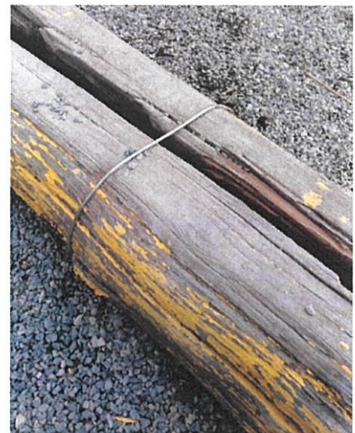
丸太の損傷状況
