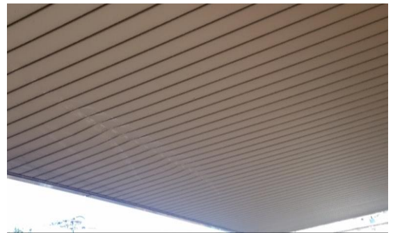
庇天井面の損傷状況
