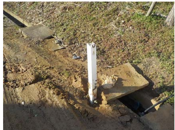
破損させた水栓柱
