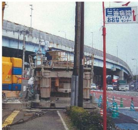
事故後の現場写真
