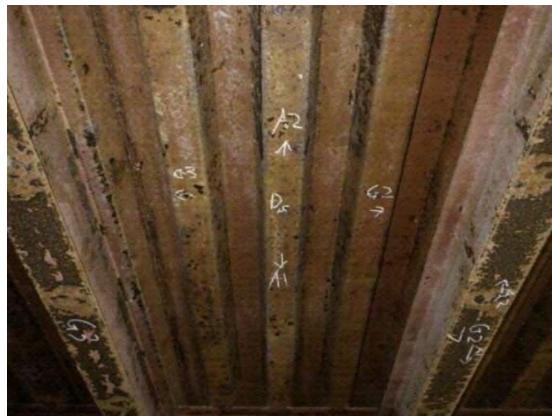
鋼橋の損傷事例
