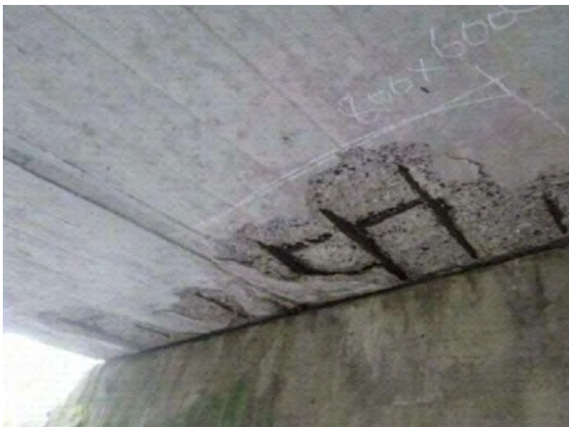
コンクリート橋の損傷事例
