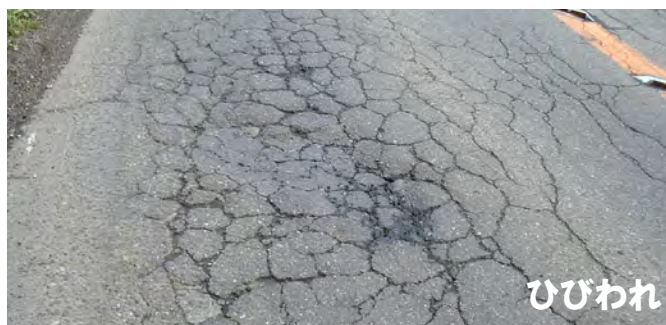
修繕前の舗装
