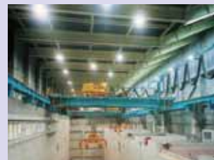
クリーンパーク臨海(ごみピット)
