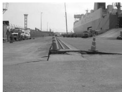
エプロンの被災状況 （平成17年3月 岸壁-12m）
