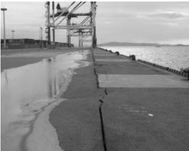
ヤードにクラックや沈下が発生 (平成17年3月香椎P P地区)
