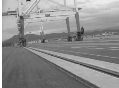
ヤードに段差が生じた (平成17年4月 I C地区)
