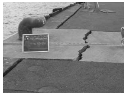
係船柱基礎の破損状況 (平成17年3月)
