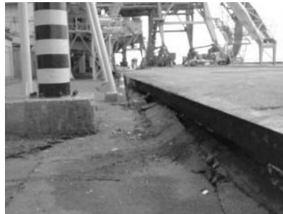
被災状況（護岸の沈下）
