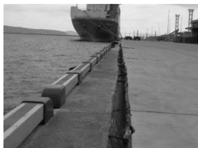
岸壁（上部工）の被災状況 （平成17年3月 岸壁-10m）
