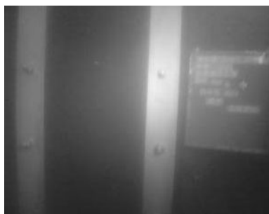
岸壁本体に吸い出し防止用の防砂目地の設置状況 （平成17年3月 岸壁-12m）
