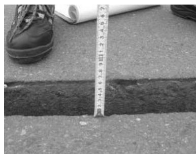
エプロンの段差状況 (平成17年3月)
