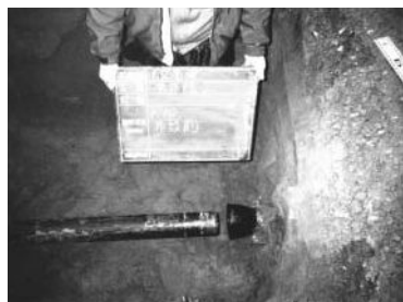
継手離脱状況
