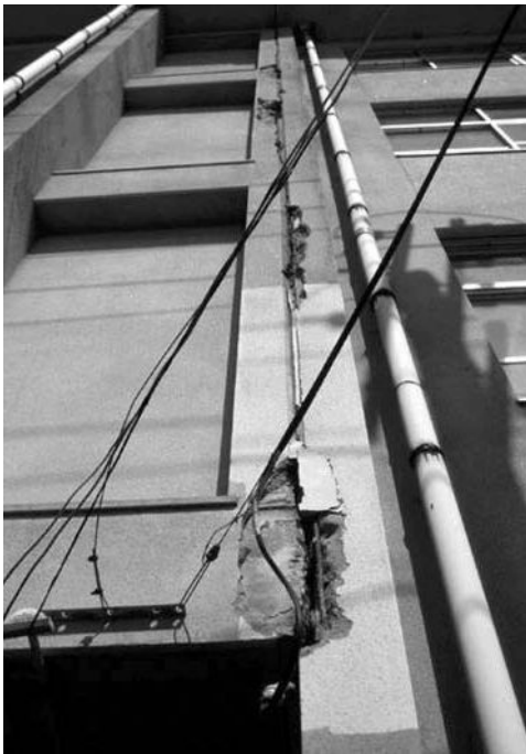
校舎外壁の被害
