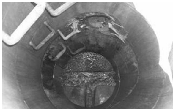
管口及びマンホール躯体破損状況
