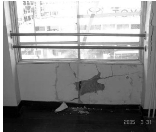
校舎内壁の被害
