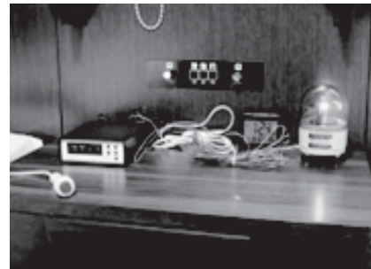
▼緊急通報ボタン(左)と、従業員からの電話連絡に反応し、文字情報や光で火災等の発生を伝える装置
