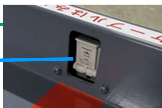
機械式駐車場充電設備
