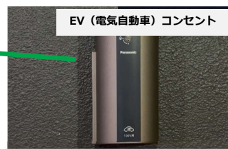
平置き駐車場充電設備
