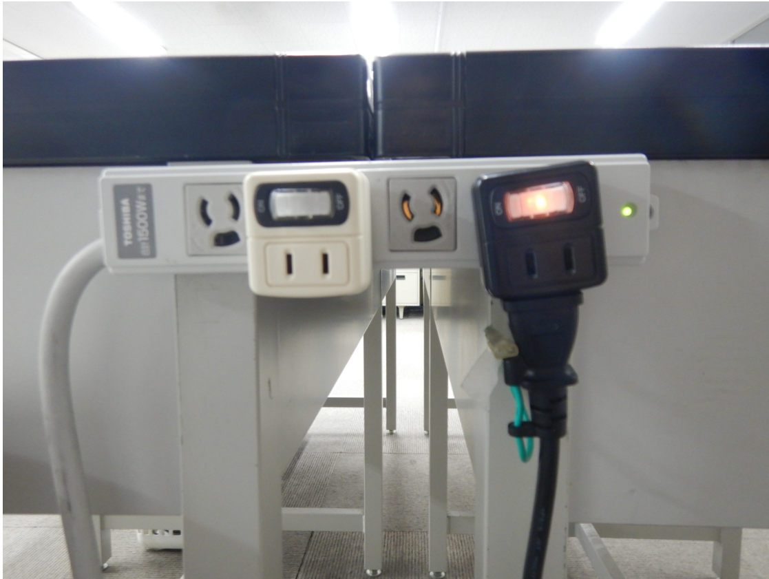
電源タップ点灯時（作業中）
