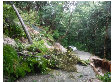
【林道被災の状況】
