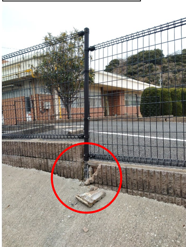
相手方施設設備損傷写真
