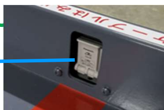
機械式駐車場充電設備
