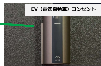
平置き駐車場充電設備
