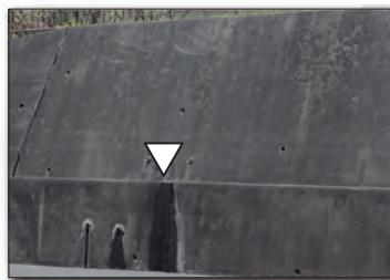
地下水の流出
