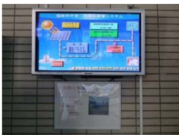
<「見える化」のイメージ (太陽光発電電量表示パネルの設置)>
