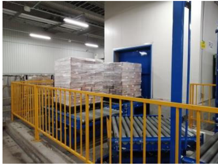
コンベアに接続されたエレベーター
