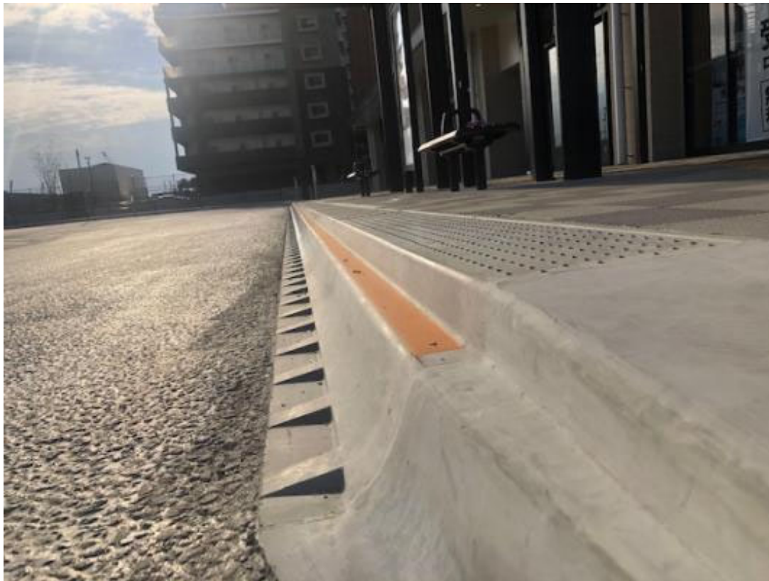
縁石の側面が普通とは違います
