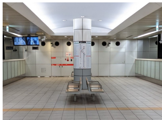
七隈線ホームのスポット空調
