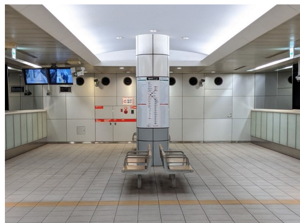
七隈線ホームのスポット空調
