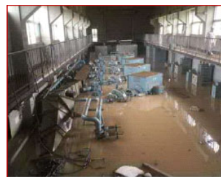
浸水被害を受けたポンプ施設 (他都市の事例)
