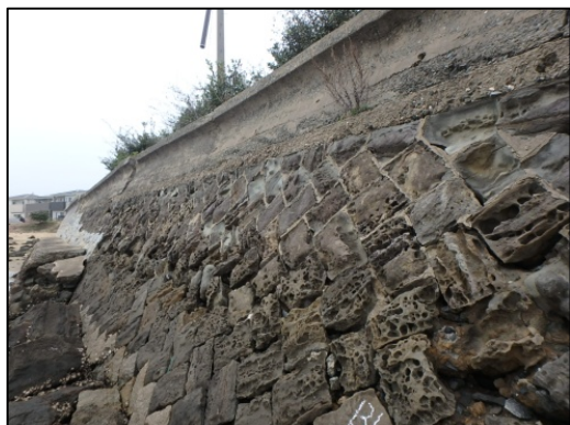
老朽化した護岸
