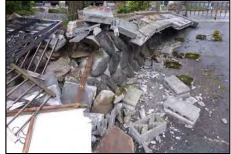
ブロック塀倒壊の様子
