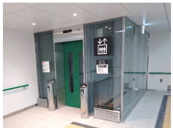
[エレベーター]
