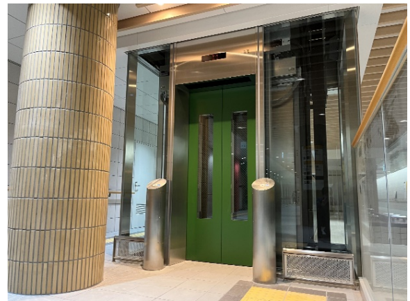
【エレベーター】
