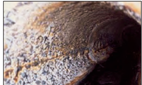
老朽化した下水道管内の状況
