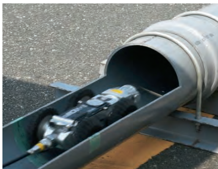
TVカメラによる劣化状況調査
