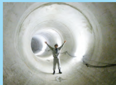
天神地区の大きな雨水管
