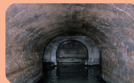
古くなった下水道管
