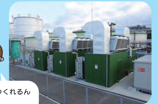
下水バイオガス発電機
