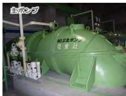
（二級河川吉塚新川排水機場）
