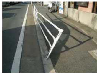
防護柵の破損
