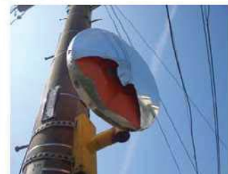
カーブミラーの破損
