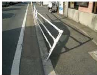
防護柵の破損
