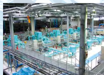
海の中道奈多海水淡水化センター(施設内部)
