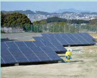
浄水場に設置している 太陽光発電パネル
