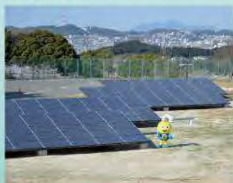
浄水場に設置している 太陽光発電パネル
