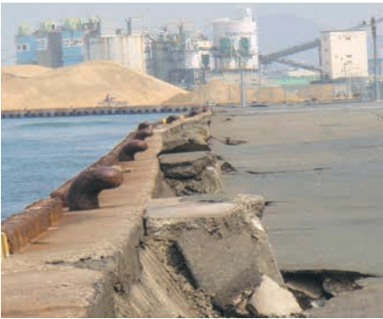
中央ふ頭の岸壁沈下(博多区沖浜町)
