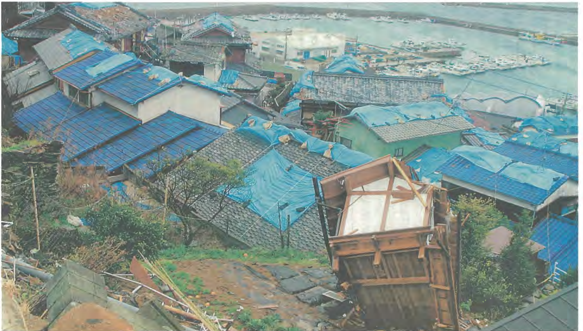
地震で損傷した屋根をビニールシートで覆った玄界島の家屋
