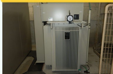
東部資源化センター受変電設備
