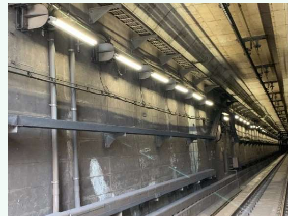
〈ずい道照明LED化〉
