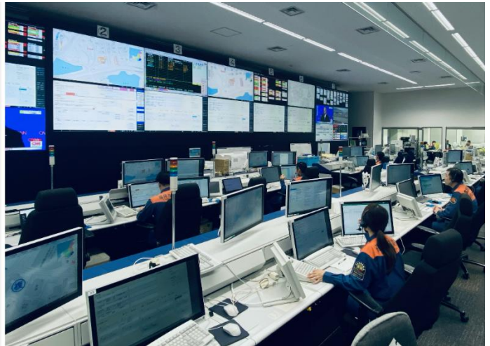
福岡都市圏消防共同指令センター
