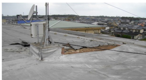
屋上防水シートの破損
