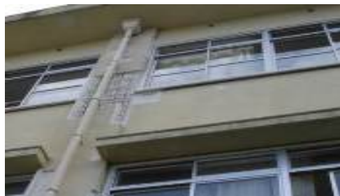
外壁の剥離落下
