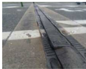
《伸縮継手の損傷》
