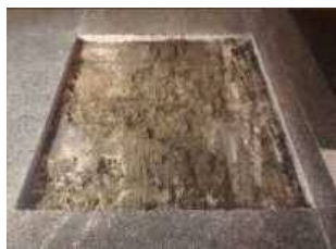
《コンクリート床版の損傷》
