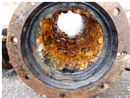
昭和44(1969)年に布設された水道管
