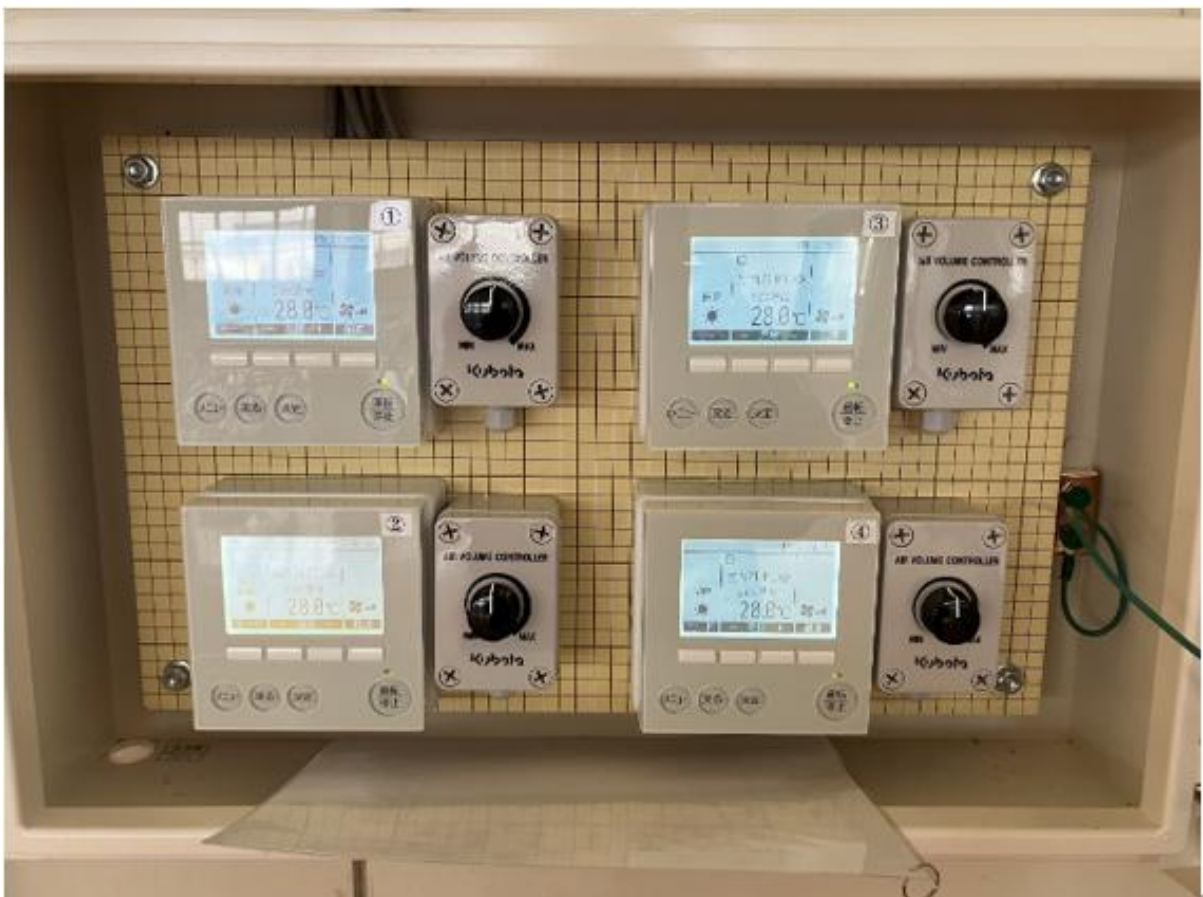
(画像 2-2：操作盤の内側の写真)
