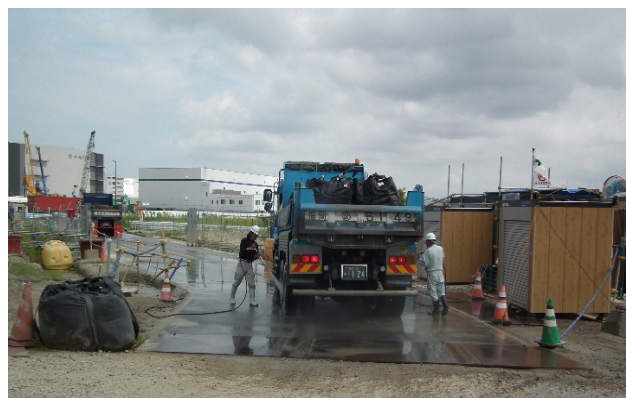
車両洗淨施設
