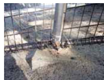
フェンス腐食
