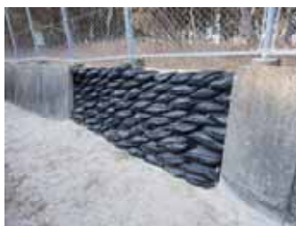
擁壁毀損部分現況
