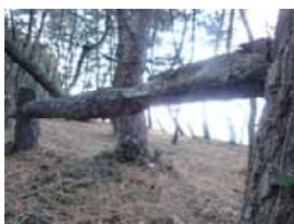
擬木柵劣化状況
