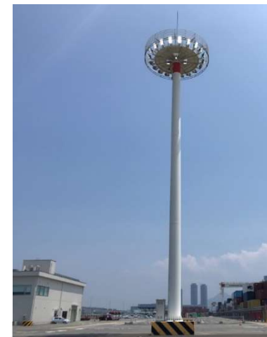
コンテナヤード照明のLED化
