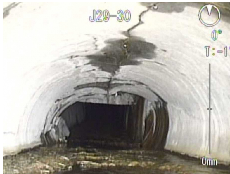
管路のひび割れと歪み状況 (松山市提供)
